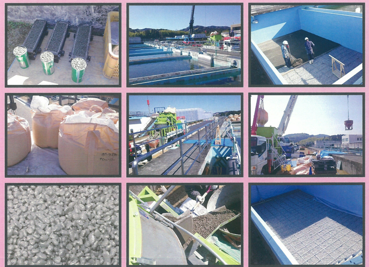
浄水場ろ過池修繕工事においてポーラス練混工事に採用、4.0m 3 /槽を2日で打設
